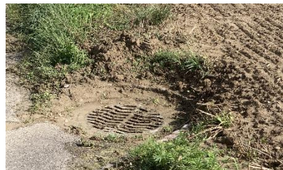
Fehlender Pufferstreifen um den Schacht: Die abgeschwemmte Erde fliesst direkt in den Entwässerungsschacht.
