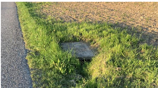
0.5 m breiter Pufferstreifen um Einlaufschacht
