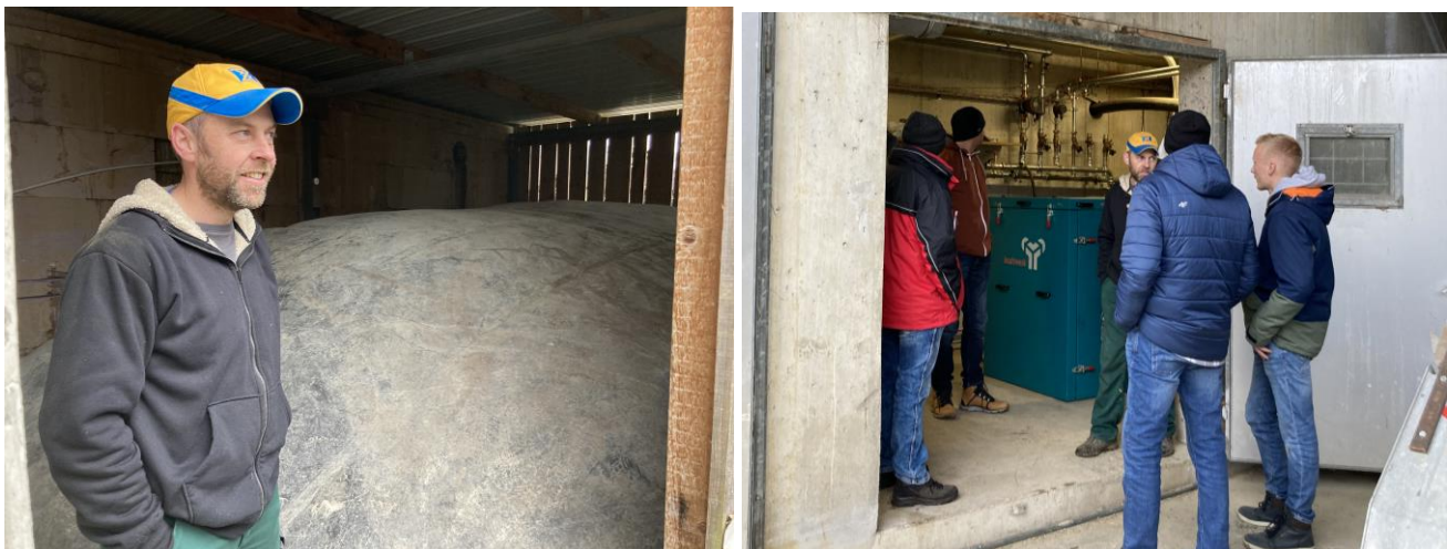
Abb 1: Joseph Vögtli vor seinem Gaskissen der Biogasanlage Abb.2: Im Blockheizkraftwerk wird das Gas zu Strom verbrannt
