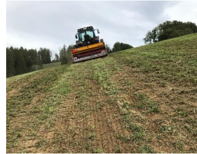
Sanierung von Mäuseschäden nach langer Schneedecke.
